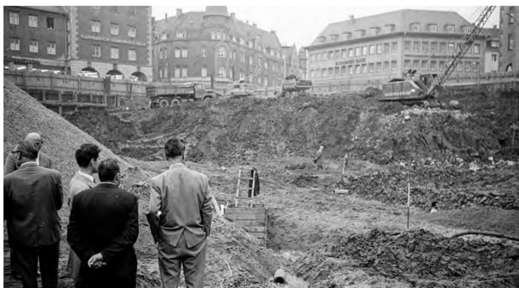
Unter den schwenkenden Armen der Baukräne, zwischen Stützwänden und Baggern, unter sich Sandschüttungen und erster Grob beton, inspizieren Ratsmitglieder am 14. Oktober 1966 die Baustelle.
