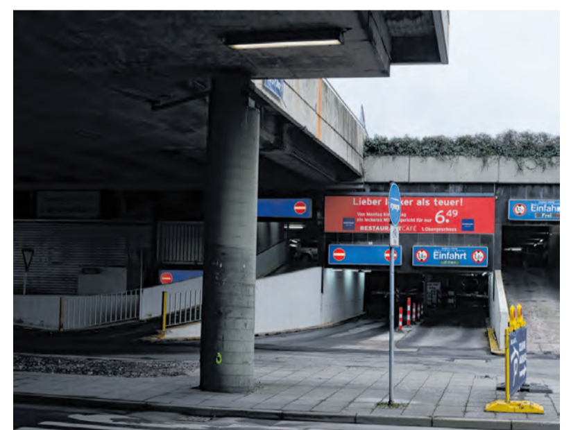
Unter der wuchtigen Brücke zwischen Schillerplatz und Rathaus ist es auch tagsüber sehr dunkel. Starke Senkungen machen dem Bauwerk zu schaffen.
