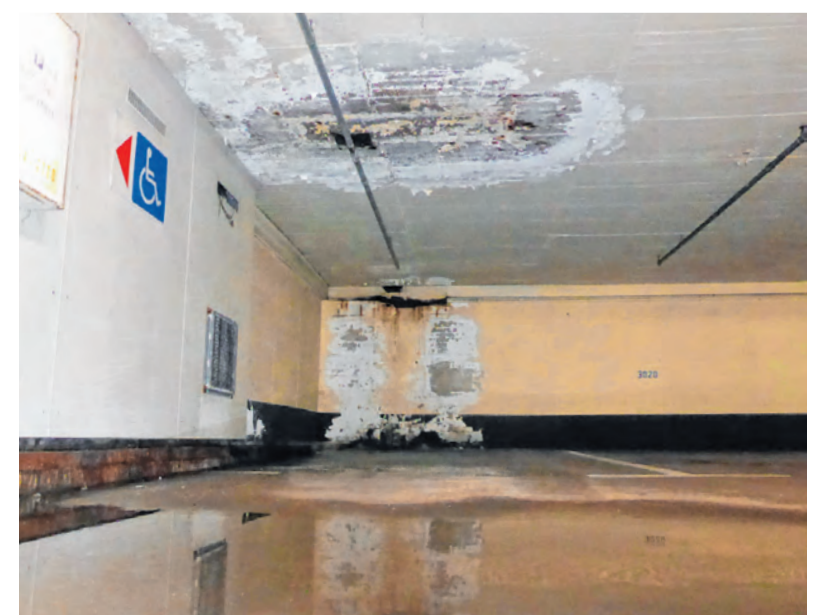
Wegen eindringender Feuchtigkeit ist das Parkhaus unter dem Schillerplatz in einem sehr maroden Zustand.
